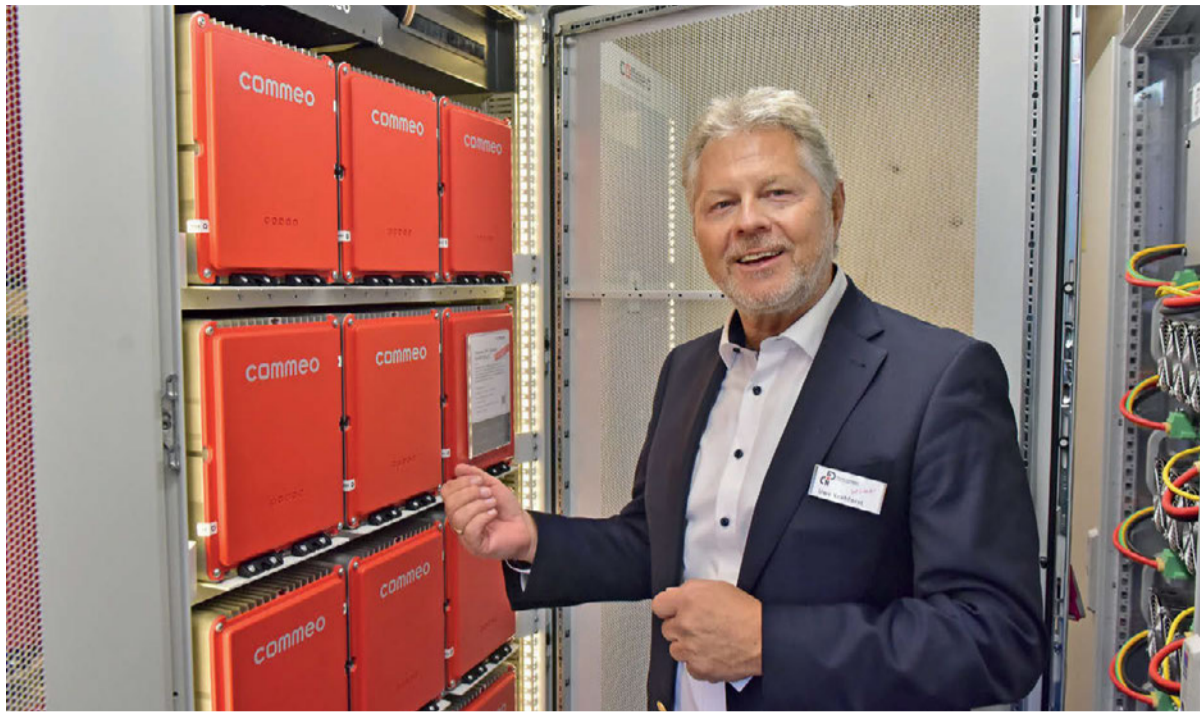
Uwe Krahorst von der Power Innovation Stromversorgungstechnik GmbH präsentiert die gegeneinander brandsicher isolierten Speicherblöcke im High Power Charging Cube.
