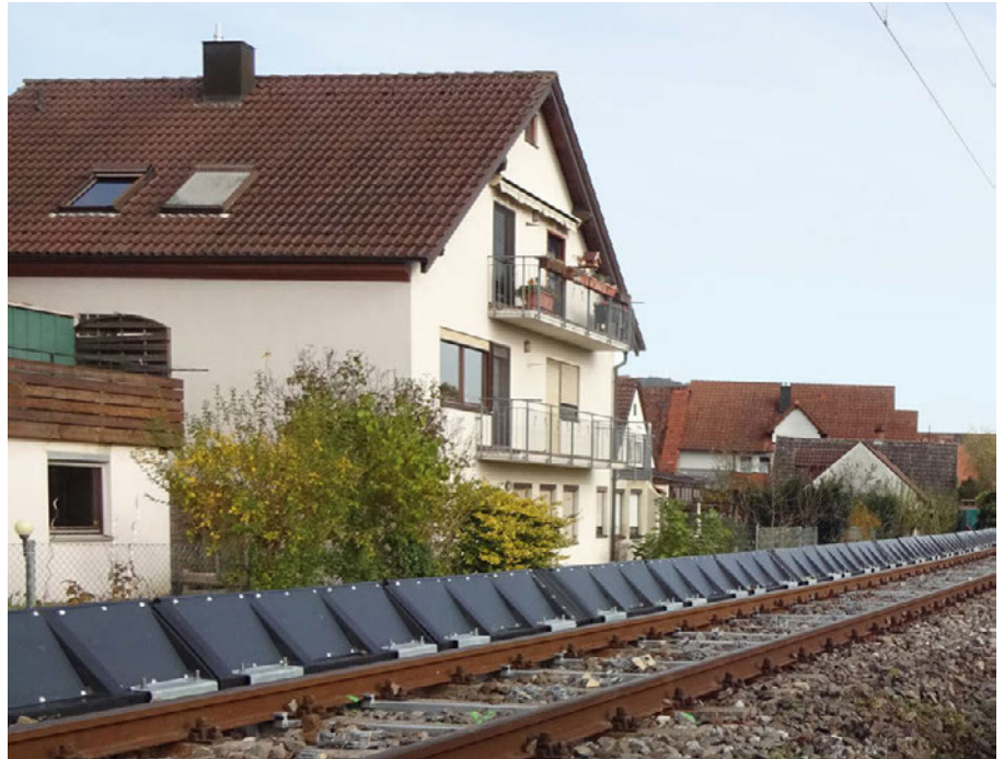
5: Im Ammertal in Baden-Württemberg kam die Mini-Schallschutzwand mit einer Höhe von 360 mm über Schienenoberkante bereits zum Einsatz
