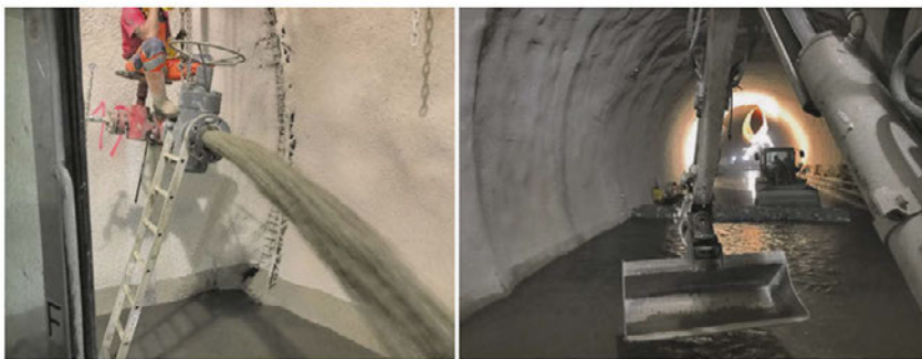
7: Auslaufversuch an der VEK119 vom 01.12.2022 und mit Wasser aus dem Auslaufversuch gefülltes, erstes von drei temporären Absetzbecken, welche im Erkundungsstollen durch das Aufschütten von Dämmen aus Tunnelausbruchsmaterial (ca. 0,8 m hoch) errichtet wurden
