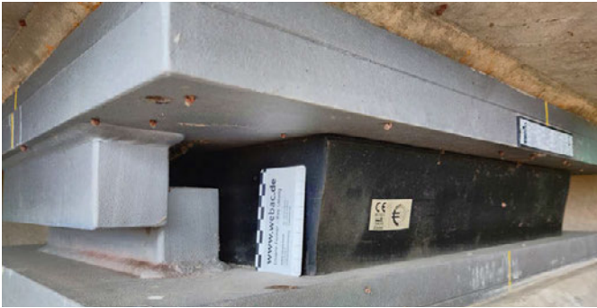
4: Überbaubewegung innerhalb der Toleranzen?
