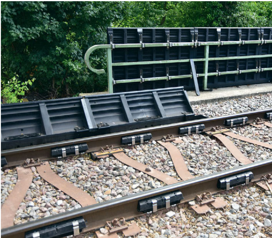
Abb. 4: Die Kombination aus Schienenstegdämpfern, Mini-Schallschutzwänden mit 55 cm Höhe und Geländerausfaltungen im Bereich einer Brücke sorgt in der Nähe eines Wohngebietes in Nordhorn (Niedersachsen) für Ruhe.
