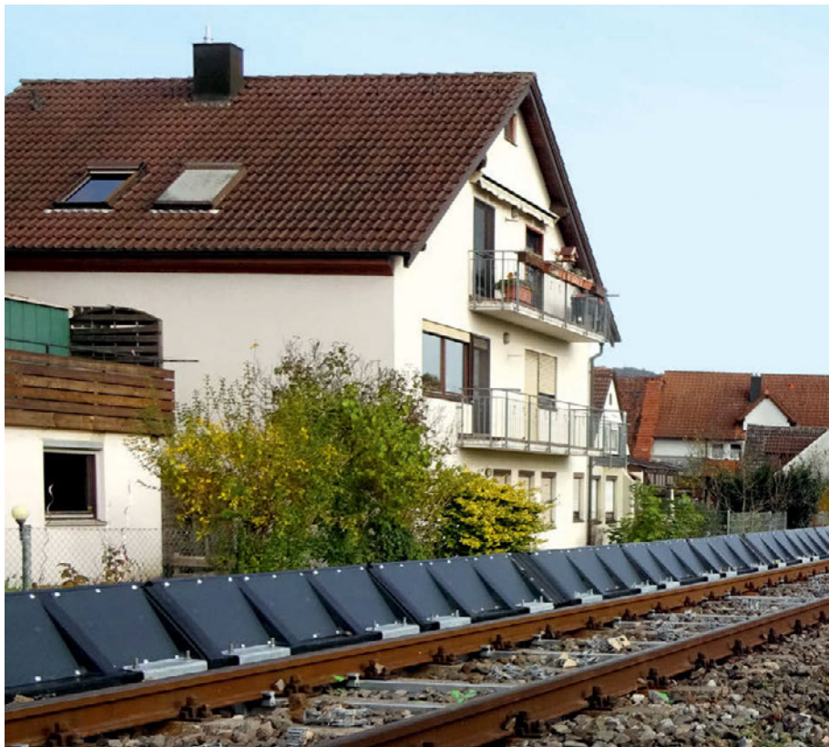
Abb. 1: Die äußerst niedrigen Schallschutzelemente an der Bahnstrecke im Ammertal stören optisch kaum, fügen sich so optimal ins Landschaftsbild ein und sorgen für Ruhe im Wohngebiet.
